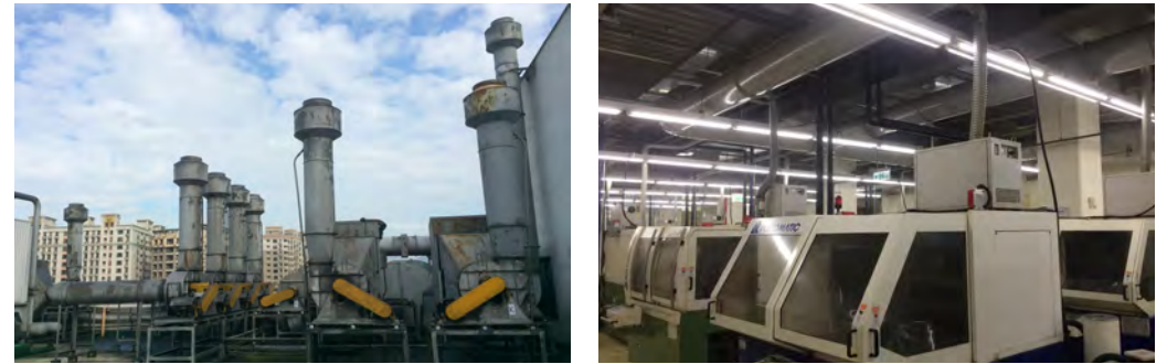
▲局部排氣裝置、靜電集塵裝置
