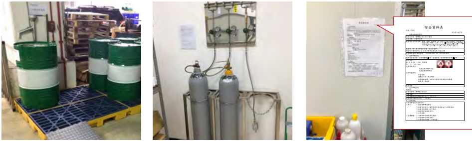
▲化學品安全衛生管理：防溢棧板、鋼瓶固定、安全資料表
